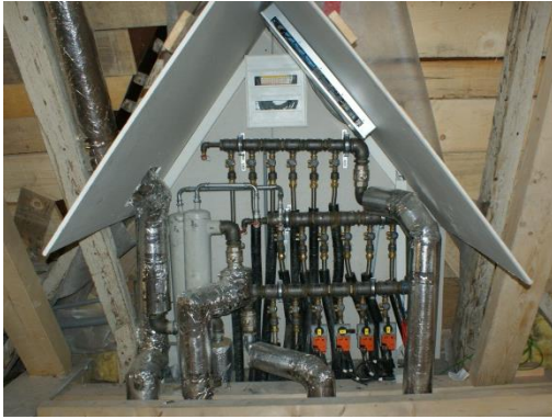
Abbildung 270: Ansicht der Rohranbindung des Kollektorfeldes im Dach (rechts), Bildquelle: AEE INTEC
