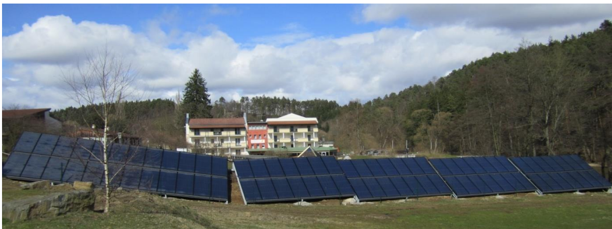
Abbildung 157: Ansicht des Hotelgebäudes im Projekt "Hotelrestaurant Liebnitzmühle", davor die aufgeständerten Kollektorfelder. Quelle: AIT
