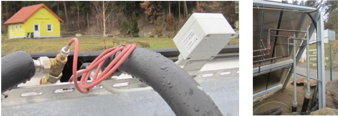
Abbildung 160: Kollektortemperaturfühler und Globalstrahlungssensor (linkes Bild), Anschluss der Kollektorverrohrung an die erdverlegten Leitungen zum Heizhaus (rechtes Bild). Quelle: AIT
