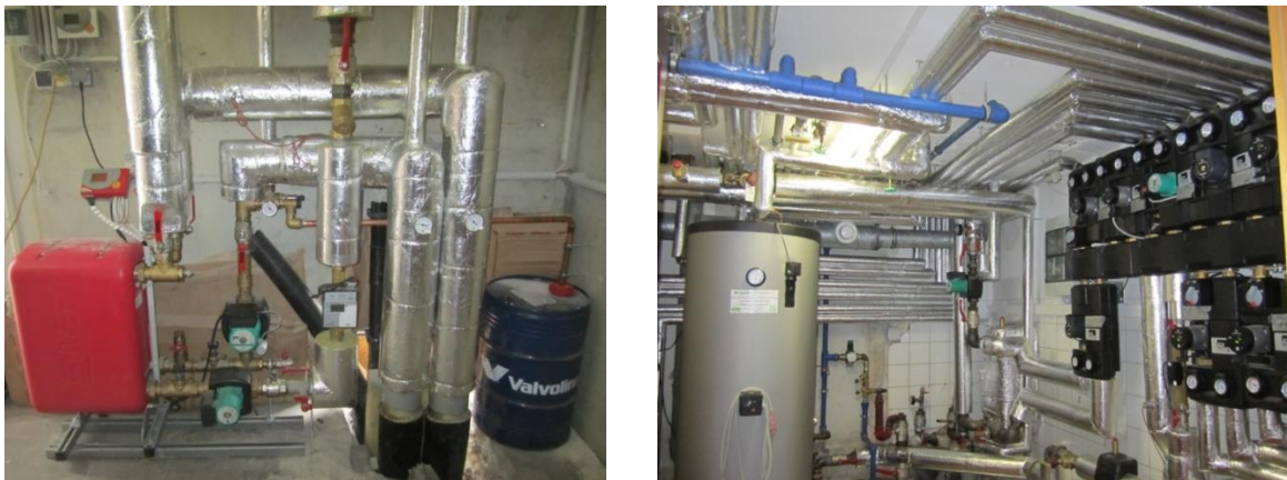
Abbildung 161: Solarwärmetauscher, Umwälzpumpen im Solarsekundär- und -primärkreis, Wärmezähler im Solarsekundärkreis sowie Anschluss an erdverlegte Leitungen zu den Kollektoren (linkes Bild, Quelle: AIT) Warmwasserspeicher und Heizungsverteiler im Technikraum des Restaurantgebäudes (rechtes Bild, Quelle: AIT)
