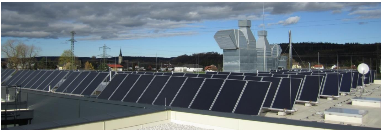
Abbildung 37: Aufständerung der Kollektorreihen. Quelle: AIT
