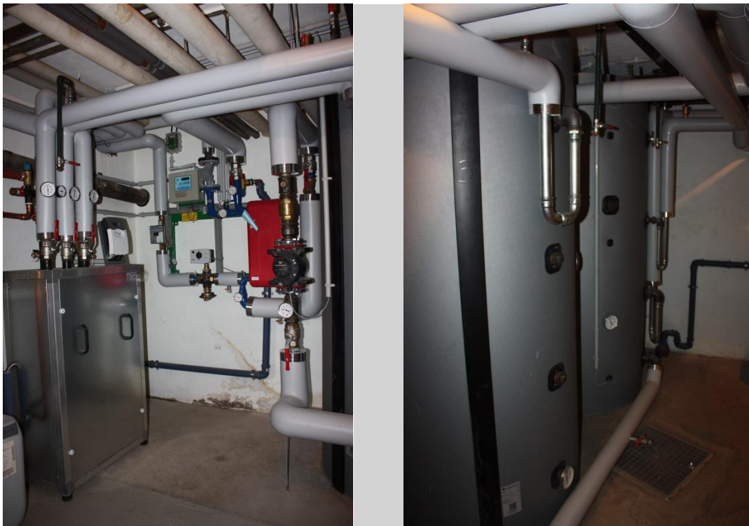
Installation Schichtlademodul und Pufferspeicher Ausführung: Fa. Reisenhofer Haustechnik - Gleisdorf
