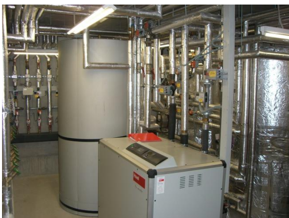
Abbildung 21: Ansicht des Heizraums der Anlage „Brandnertal Gastronomie“. (Bildquelle: Frööd).
