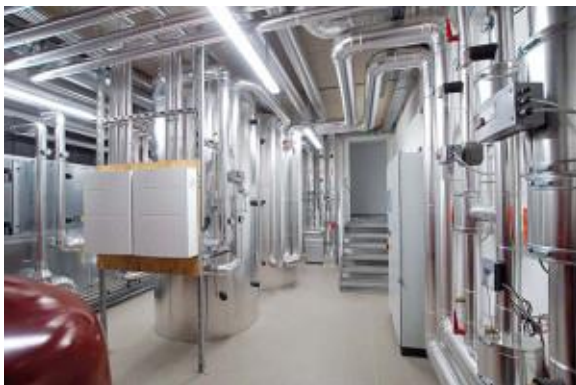
Abbildung 7: Ansicht des Heizraums inkl. der beiden Pufferspeicher des Kultur- und Veranstaltungszentrums Hallwang (Bildquelle: www.kuster.co.at )
