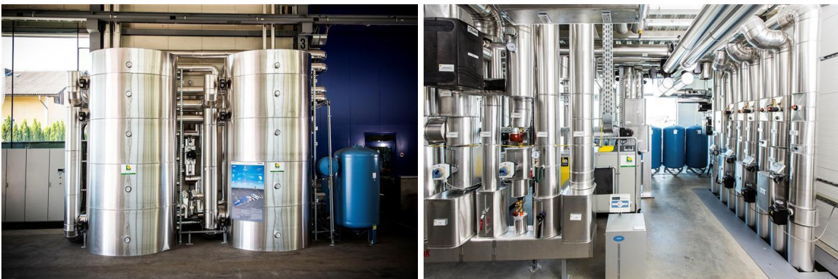
Abbildung 27: Ansicht der beiden Pufferspeicher in der Fassadenbauhalle (linke Darstellung) bzw. Ansicht der Heizzentrale in der „E-Productions Halle“ (Bildquelle: Firma H. Traussnigg GmbH).
