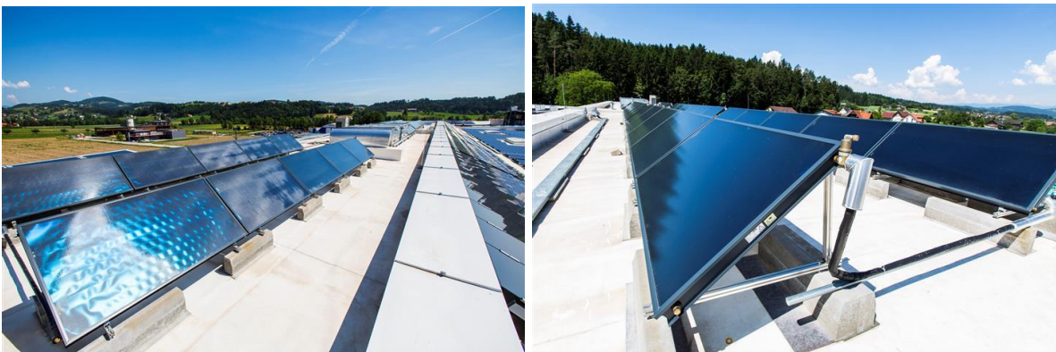
Abbildung 28: Ansicht des Kollektorfelds am Dach des neu errichteten „E-Productions Halle“ (Bildquelle: Firma H. Traussnigg GmbH).
