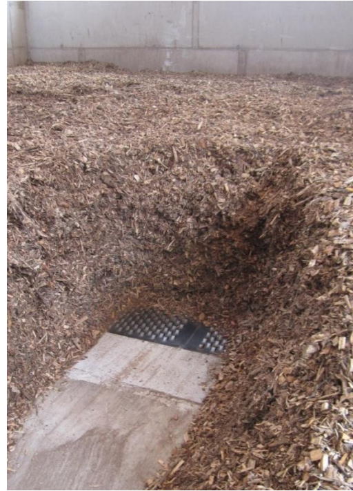
Abbildung 46: Mit Hackschnitzel beladener Flachrost. Rost zur Demonstration teilweise freigelegt. Quelle: AIT
