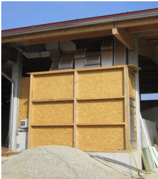
Abbildung 41: Außenansicht des Sammelschachts mit den sechs Luftkanälen (oben), die die Luft von den Kollektoren führen. Quelle: AIT
