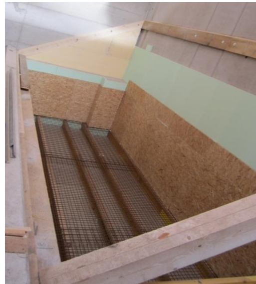
Abbildung 42: Steinspeicher – zum Zeitpunkt der Aufnahme noch im Bau befindlich, daher noch ohne Steine – der sich unter dem noch nicht fertiggestellten Schrägrost befindet. Die Luft wird durch das Gitter von unten in den Speicher geblasen (grün: Dämmschicht). Quelle: AIT
