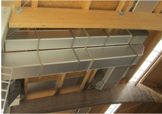
Abbildung 39: Luftkanäle unter der Hallendecke. Quelle: AIT
