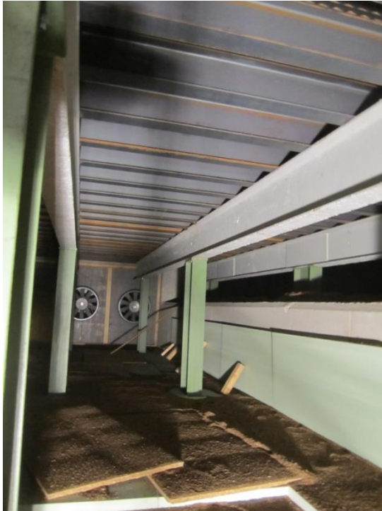
Abbildung 45: Luftverteilschacht unter dem Flachrost mit Ventilatoren (Hintergrund). Quelle: AIT
