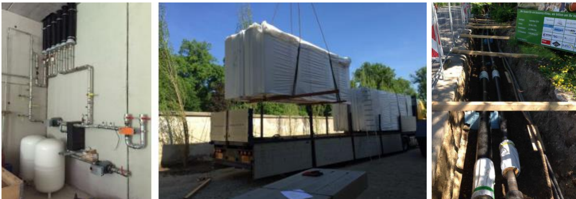
Abbildung 3: Darstellung der Solarkreiswärmetauscher inkl. Ausdehnungsgefäße (linke Darstellung, Quelle: BC Regionalwärme Ebenthal, Ingenieurbüro für erneuerbare Energie), Anlieferung der Solarkollektoren im Zuge der Errichtung (mittlere Darstellung, Quelle: BC Regionalwärme Ebenthal, Ingenieurbüro für erneuerbare Energie), Fernwärmeleitungsbau mit vorisolierten Kunststoffmantelrohren (Quelle: QM-Baubericht, BC Regionalwärme Ebenthal)
