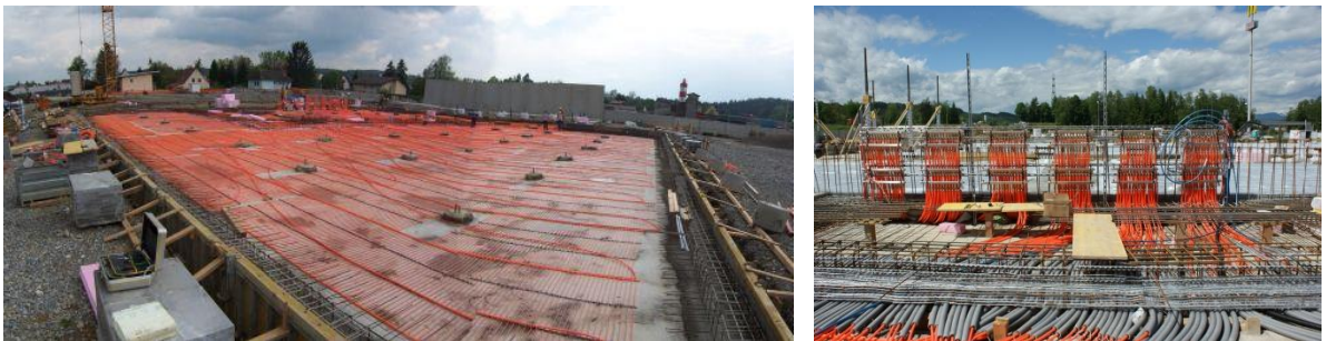
Abbildung 3: Ansicht des Rohrregister (links) Verteiler und Verrohrung der Rohrregister für den Erdspeicher (rechtes Bild) im Zuge der Errichtung (Quelle: AEE INTEC)
