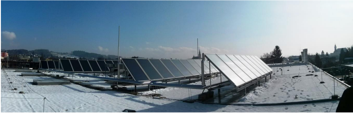
Abbildung 2: Ansicht der am Dach des Autohauses aufgeständerten Kollektoren (Bildquelle: AEE INTEC)
