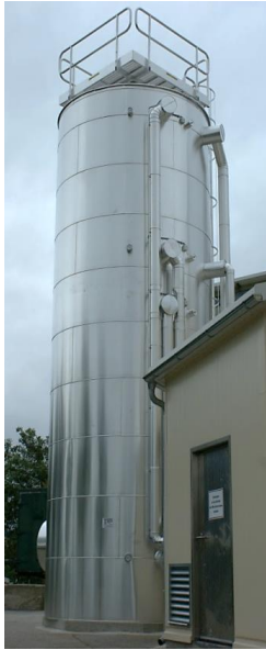
Abbildung 339: Ansicht des am Werksareal der Fa. Fleischwaren Berger befindlichen 60 m 3 Pufferspeichers (Bildquelle: SOLID)
