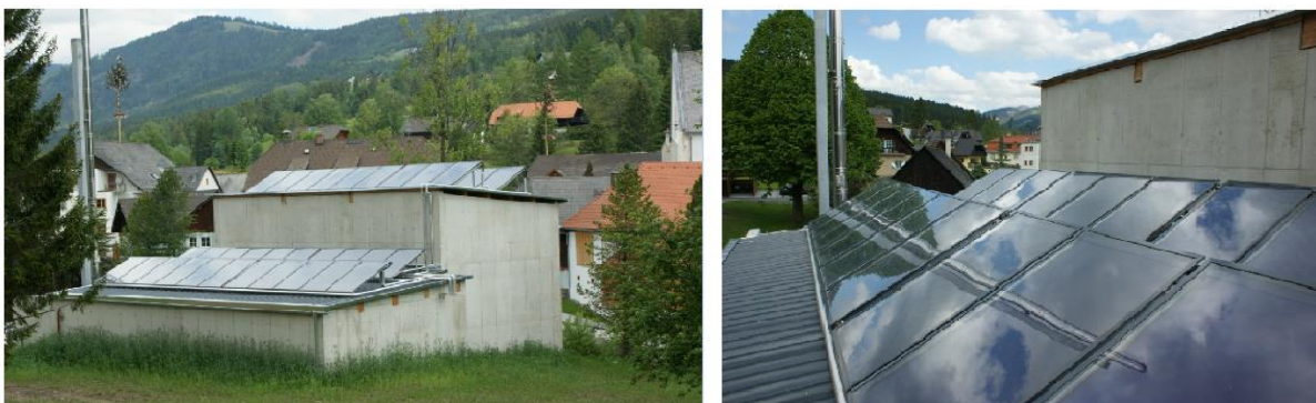
Abbildung 19: Ansicht des Heizwerks der Anlage „Biowärme Hirschegg“ mit den aufgeständerten Kollektoren (links) sowie eine Detailaufnahme der vorderen Kollektorreihen (rechts), Bildquelle: AEE INTEC
